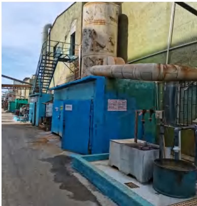
图4.5-12 废气治理设施
