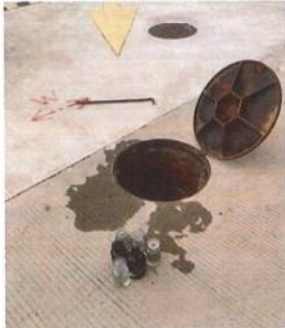
生活污水、初期雨水及地面冲洗水 排放口
