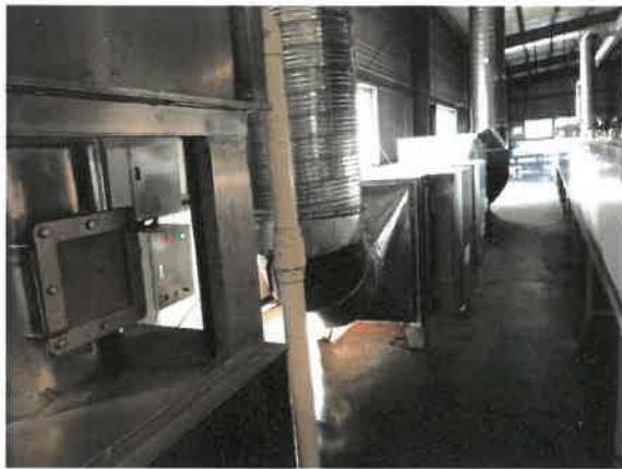
废气处理设施
