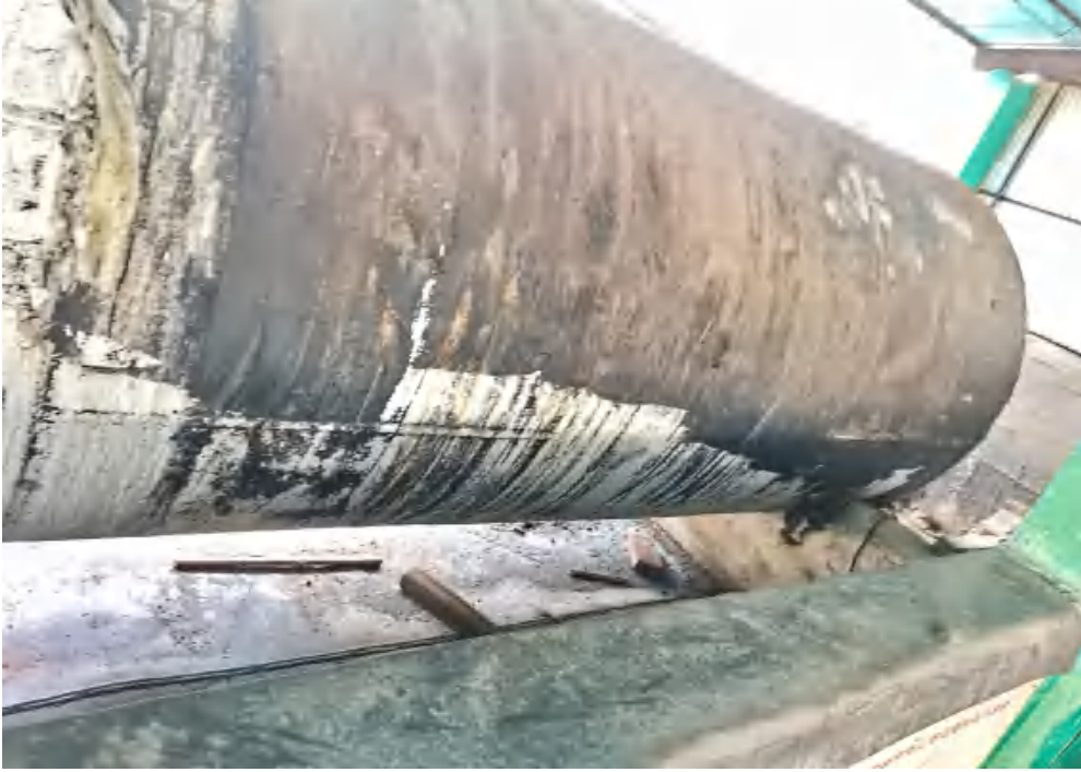
图4.5-2 危险化学品储罐
