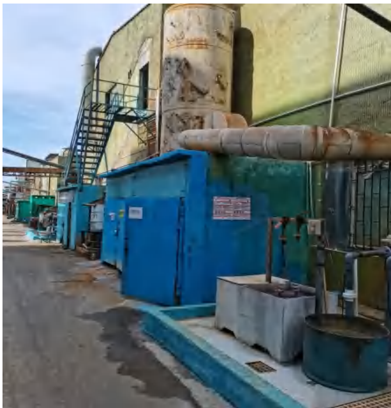
图4.5-12 废气治理设施
