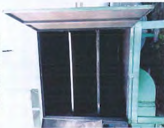
浸漆房活性炭吸附塔
