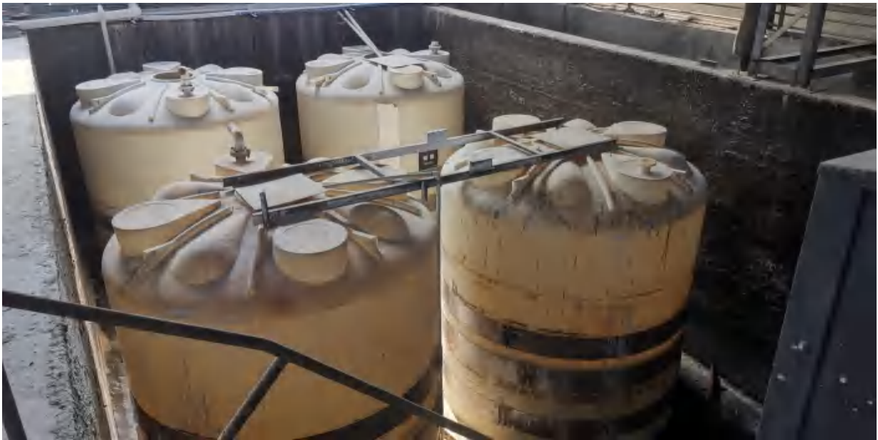
图 4.5-3 硫酸储罐现场排查照片
