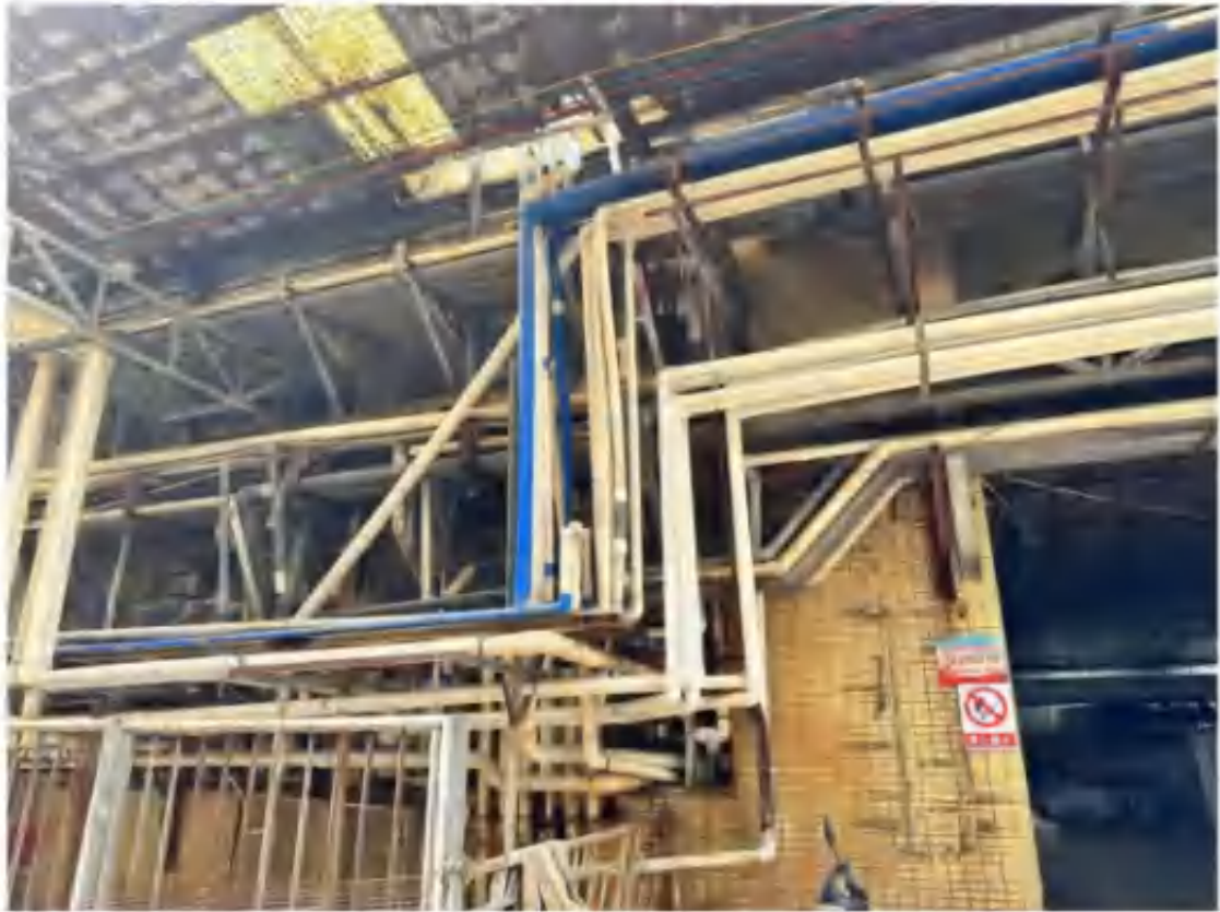
图 4.5-4 废水收集管道
