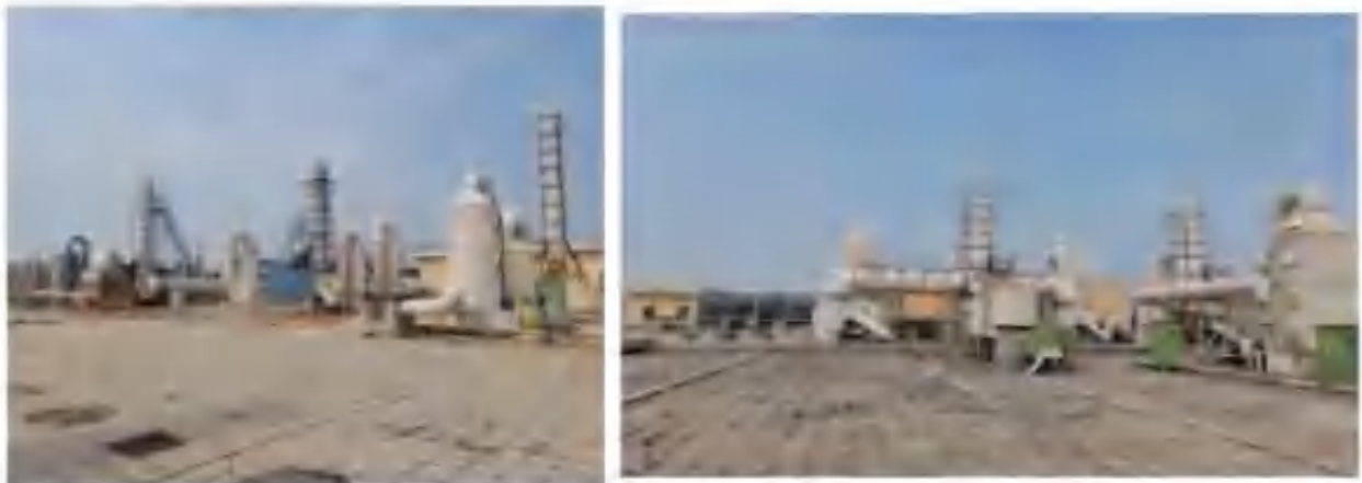
图 4.5-5 废气治理设施
