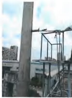
锅炉废气排放口 1# (FQ-008621)
