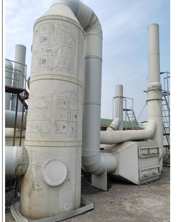
废气处理设施
