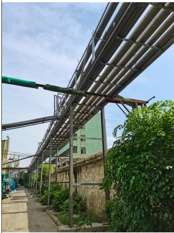
废水输送管道
