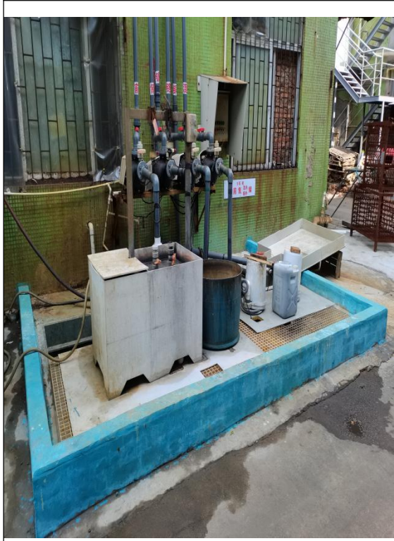
车间废水收集池
