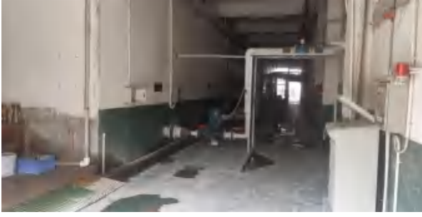
图 4.2-5 废水治理设施阀门现场排查照片
